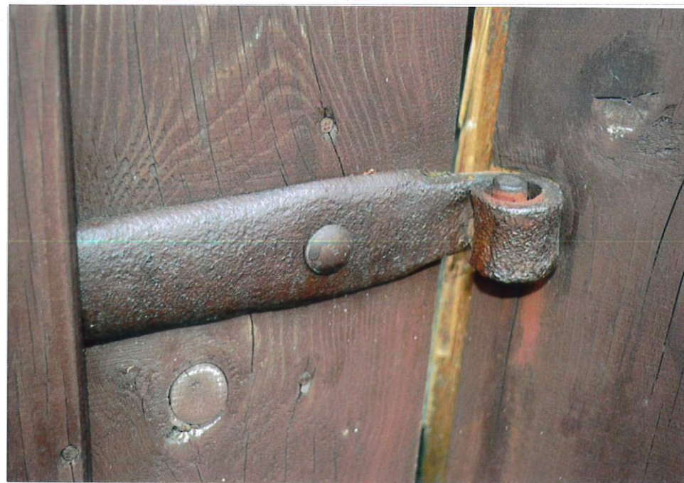
Fot. 3. Zawias czopowy drzwi zewnętrznych, fot. P. Szczurek, 2021.
